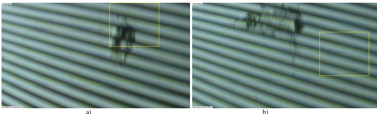
Figura 64. a) Grieta detectada como fisura b) Grieta no detectada y falso positivo detectado
