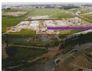
Planta de tratamiento del Rio Salitre
