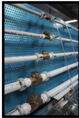
Ilustración 12. Tuberías de PVC montadas en el banco de presión.
