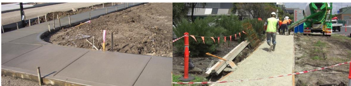
Imagen 2 a) Andén Westgate Freeway b) Sendero Peatonal en Lyndarum Estate. Fuente: Zeobond Projects
