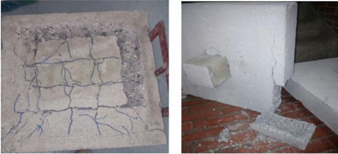
Figura 55. Falla por punzonamiento sistema # 4
