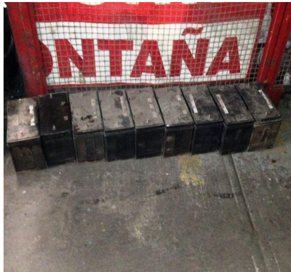
Foto 9. Baterías Plomo ácido
