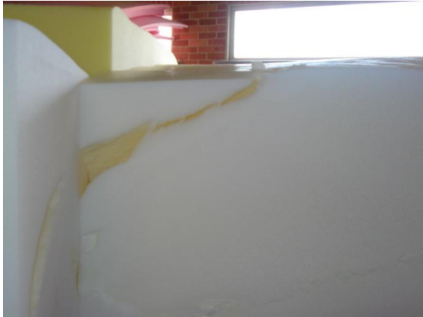
Ilustración 11. Defectos en los bloques de espuma II.
