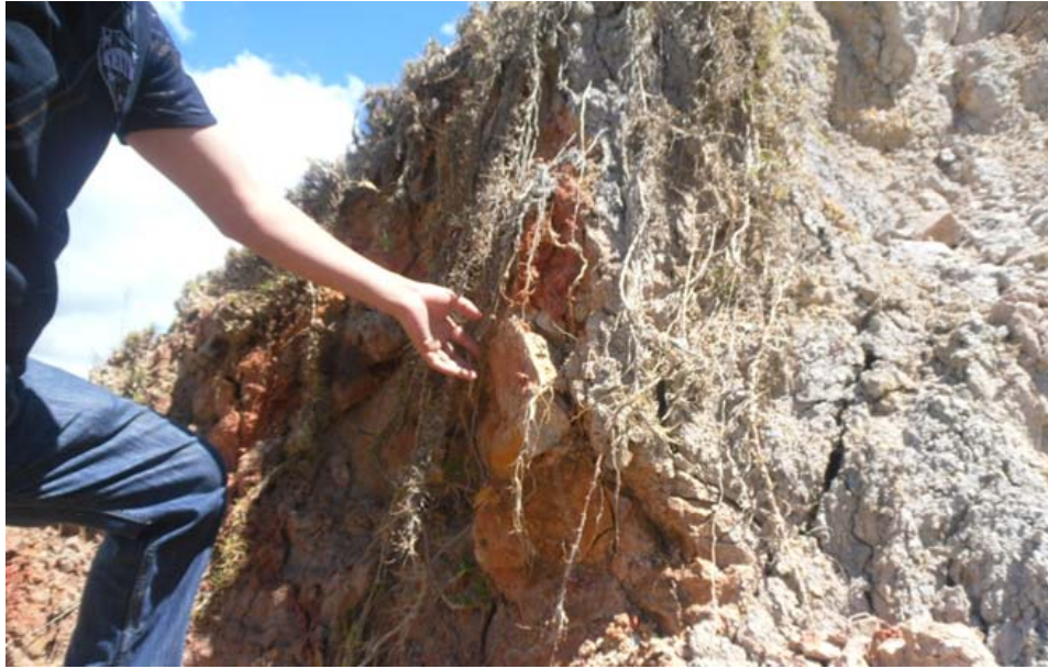
Figura 3-11 Talud No 2 Choconta
