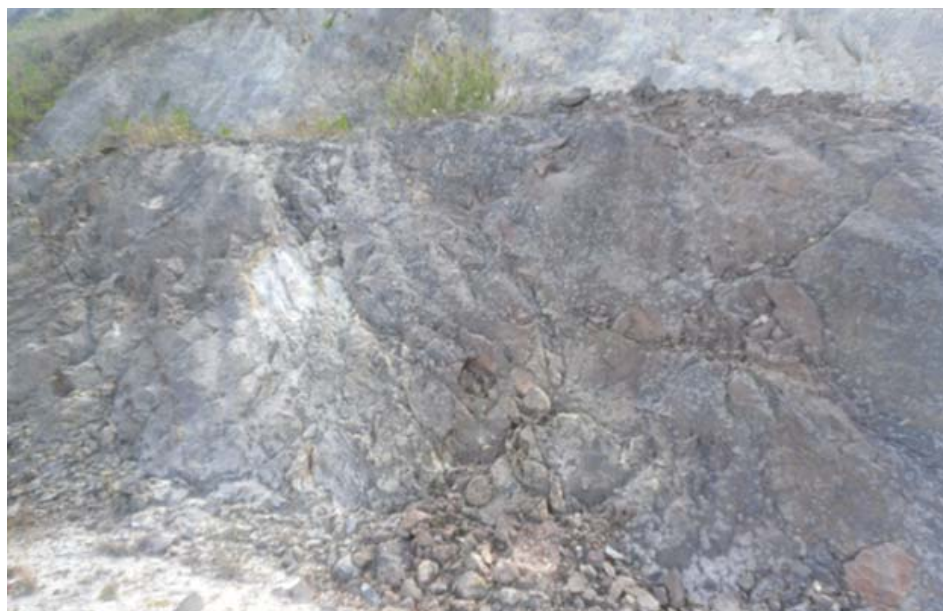
Figura 3-10 Talud No 1 Gachancipa - El Roble
