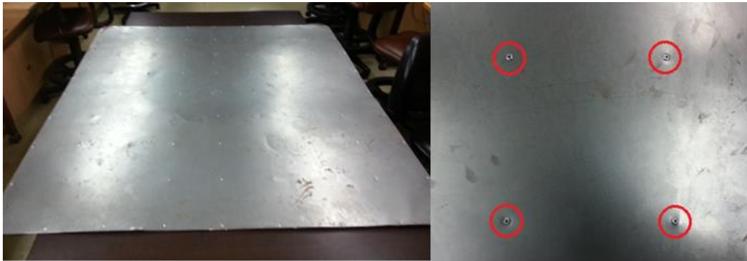
a b Figura 51 Plano de tierra: a) Vista total, b) Detalle de conexiones
