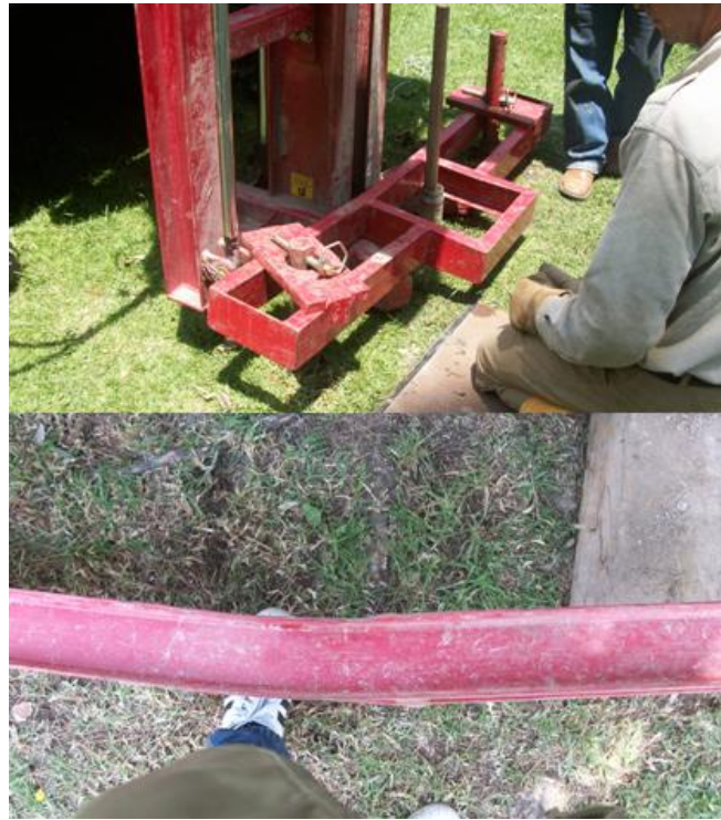
Figura 31. Parte del anclaje doblado.
