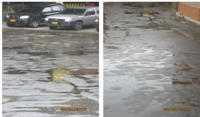
Figura 2 Acumulación y detención de agua sobre la superficie de la vía. Fuente: Propia, 2013
