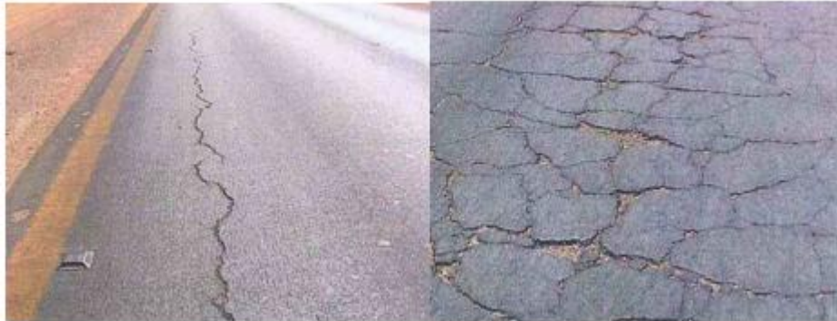
Figura 2-1. Agrietamiento por fatiga
