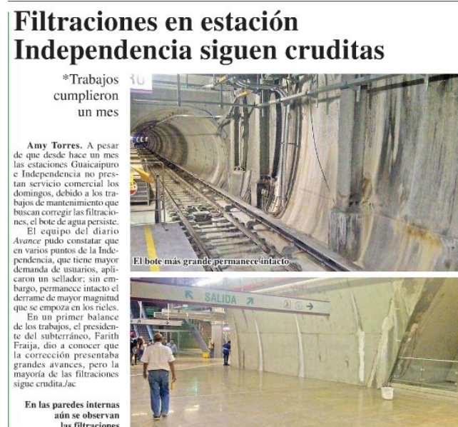
Figura 36. Evidencia problemas de calidad en obras (Torres, 2014)
