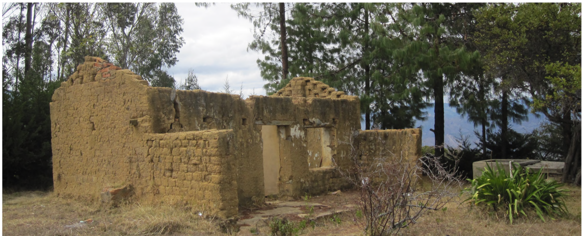
Casa en ruinas con técnica de adobe, vereda La Costa, Municipio de Soatá Fuente: Nicole Moreno, Agosto de 2015
