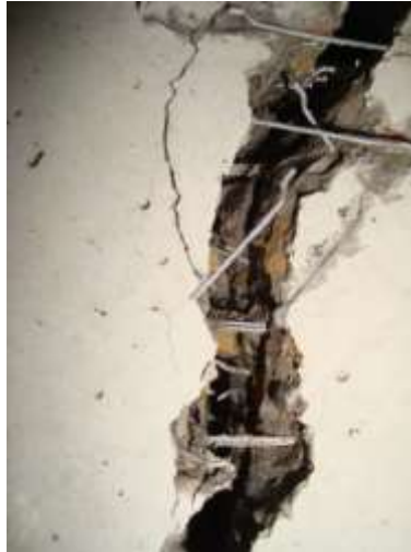
Figura 47. Falla de vigueta con adición de fibras metálicas.
