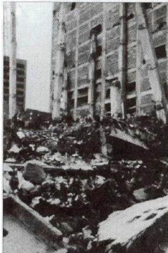
Figura 8. Falla por punzonamiento (Murillo, 2004).
