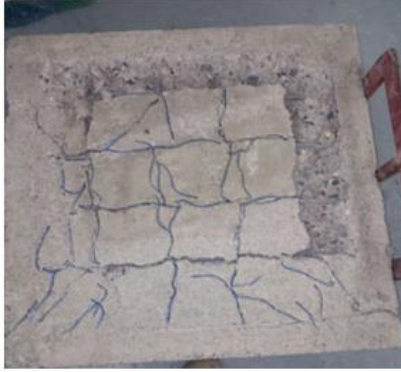
Figura 31. Falla punzonamiento (Álvarez, Torres, 2015)
