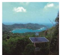
Energía: Paneles solares
