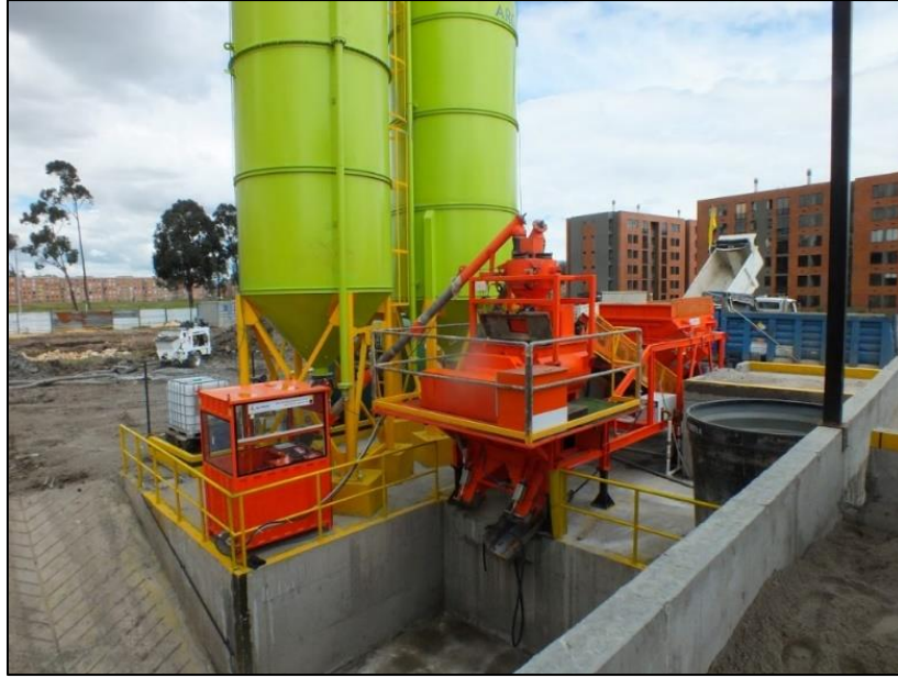
Fig. 6. Planta de concreto Altron AM-25 / 2017
