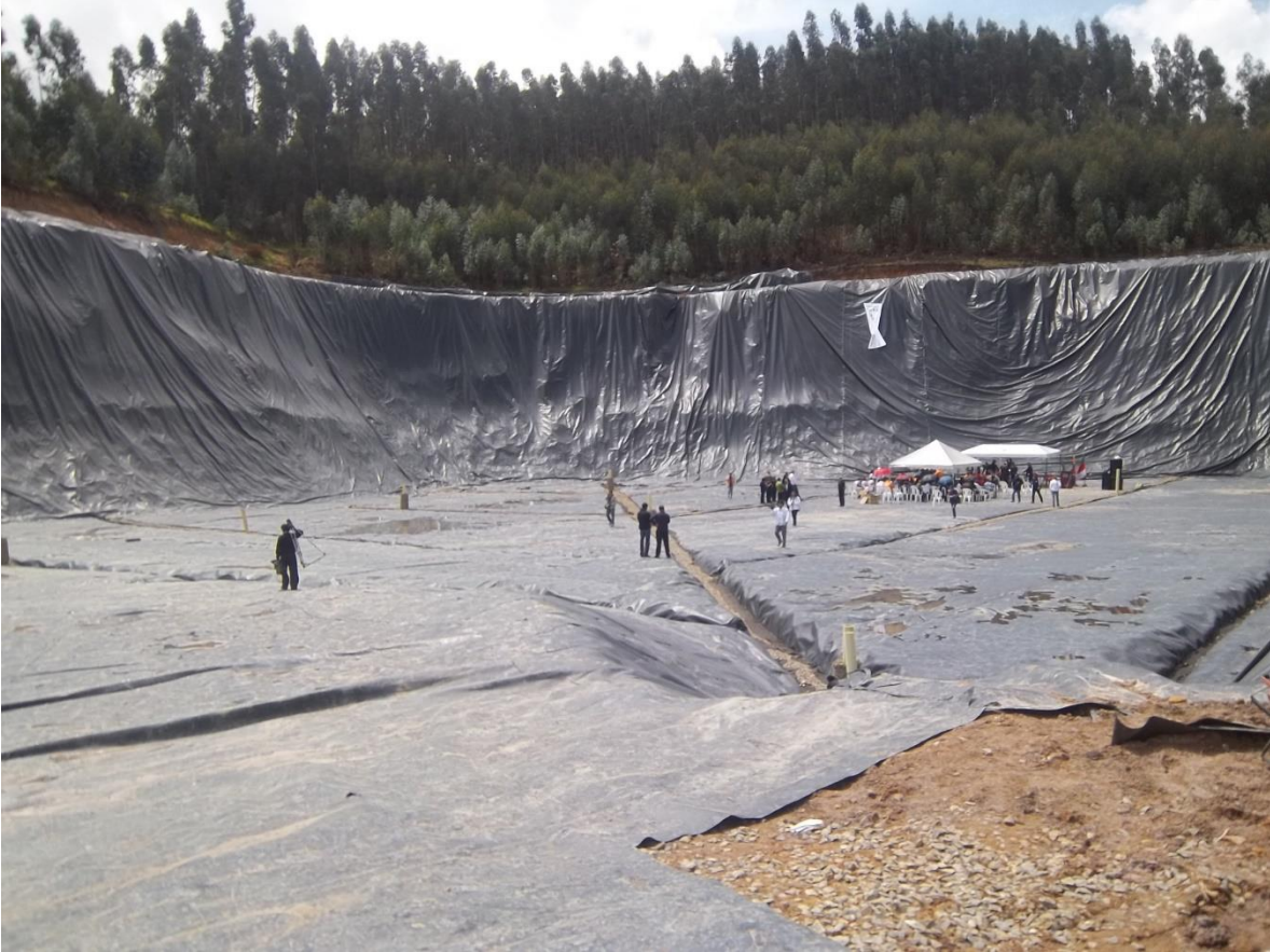
Figura 5 Espitia, C. (1994) Construcción de las terrazas 12 nivel A Y B en el Relleno Sanitario [fotografía]. Operación y construcción simultánea.
