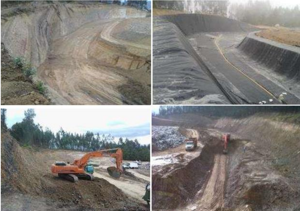
Figura 4 Espitia, C. (1994) Construcción de las terrazas en el Relleno Sanitario [fotografía]. Método de disposición: tipo terraza trinchera, Se elaboran estudios: topografía, geología, suelos, topografía, diseño de vías, tratamiento lixiviados, evacuación gases
