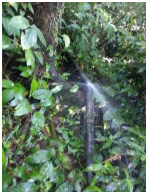
Figura 5. Fuga del tubo principal que lleva el agua a la comunidad. Fuente Deyci Rodriguez 2021
