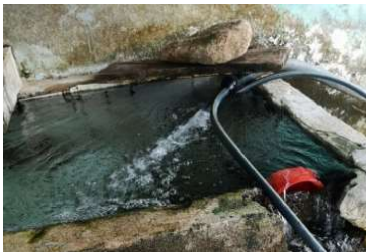
Figura 6. Conexión de agua hacia la escuela. Fuente Deyci Rodriguez 2021
