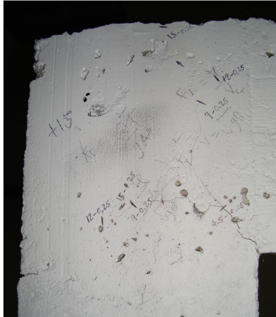
Imagen 8.8. Fisuras generadas en el nudo 1
