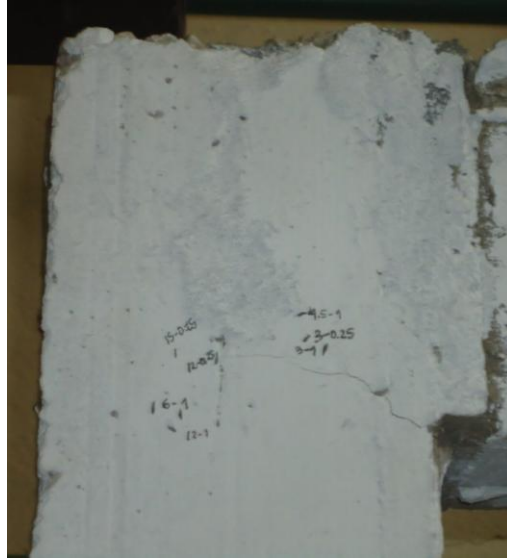
Imagen 8.2. Fisuras generadas en el nudo 1
