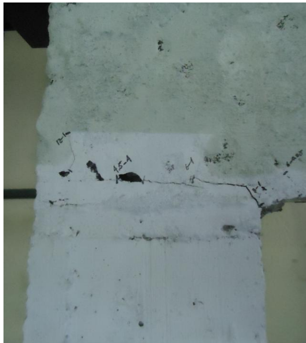
Imagen 8.5. Fisuras generadas en el nudo 1
