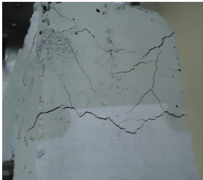
Imagen 8.7. Unión de fisuras en la columna
