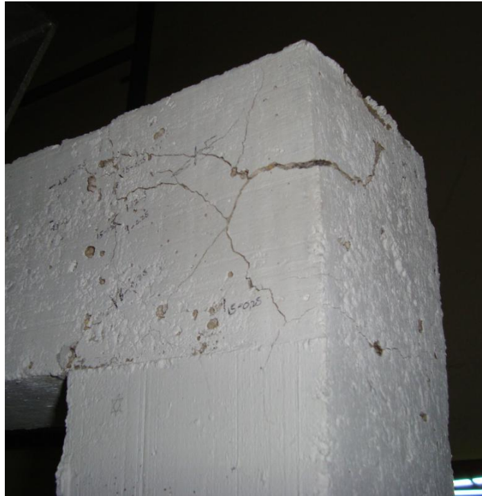
Imagen 8.10. Unión de fisuras en la columna
