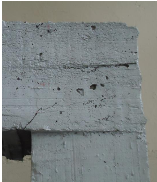
Imagen 8.3. Fisuras generadas en el nudo 2
