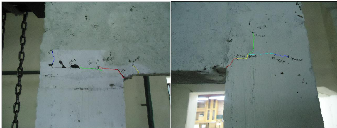
Imagen 8.12. Determinación de la longitud de fisuras para el pórtico 2
