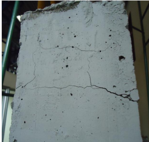
Imagen 8.4. Unión de fisuras en la columna
