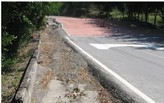
Fotografía 2. Desplazamientos en la vía
