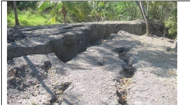
Fotografía 1. Corona deslizamiento, PR 69+530.
