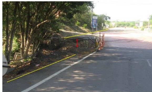
Fotografía 3. Desplazamientos en la vía.
