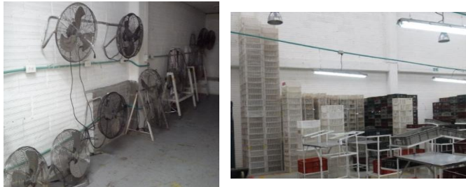
Figura 33 Cuarto de secado y colas generadas por el mismo
