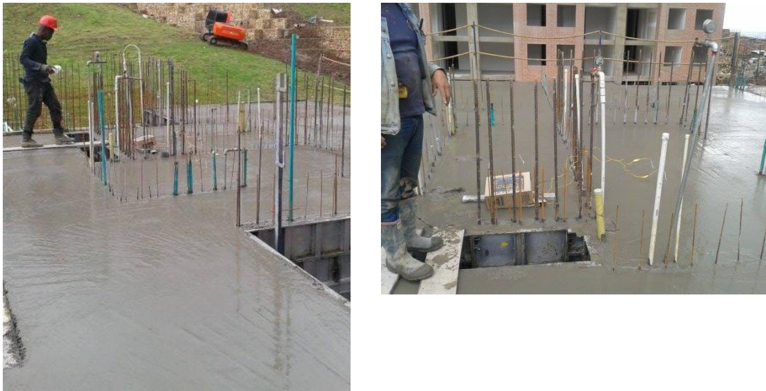
Figura 3.20 Instrumentación Placa – Obra Punta del Este
