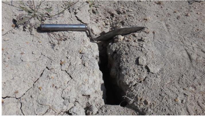
Fotografía 6. Material encontrado en la parte baja del talud
