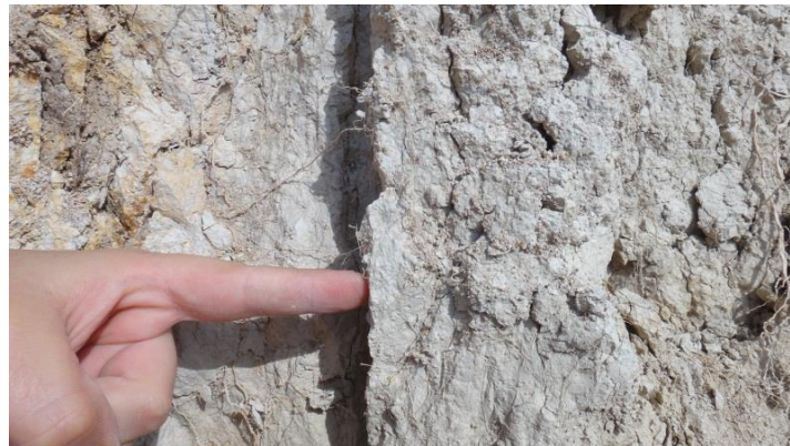
Fotografía 5. Material encontrado en la parte alta del talud
