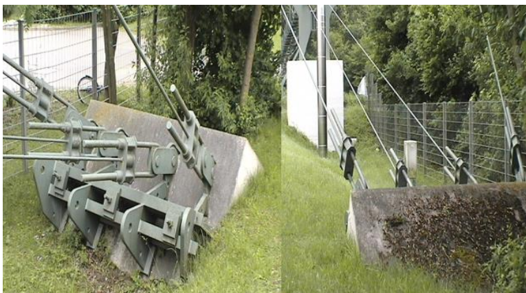
Imagen 4.10 Macizos de anclaje en paso aéreo en Aldingen, Baden-Wuttenberg, Alemania. Tomado de Bernstorff, E. (2005)
