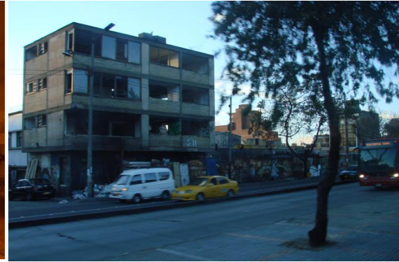
Construcciones deterioradas y abandonadas-presencia de basuras y escombros que reducen el tránsito
