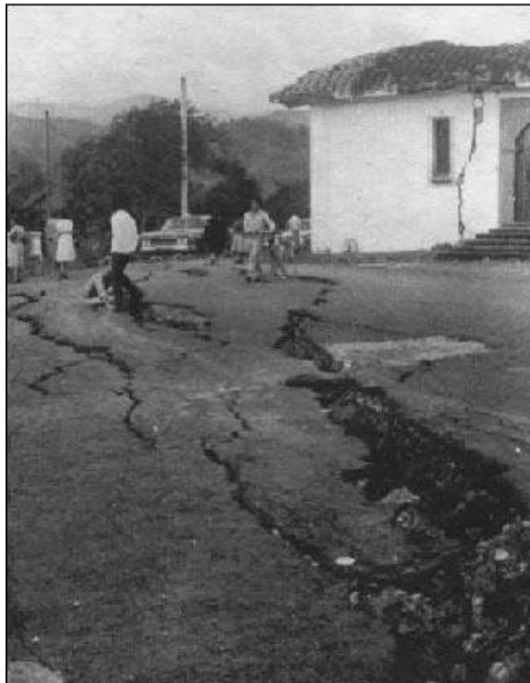
Fig 3. Grieta en Vía después de terremoto
