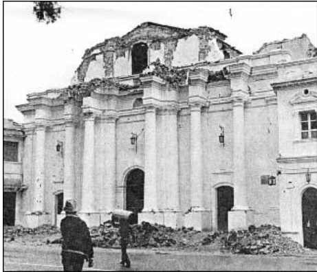
Fig 1. Iglesia después de terremoto
