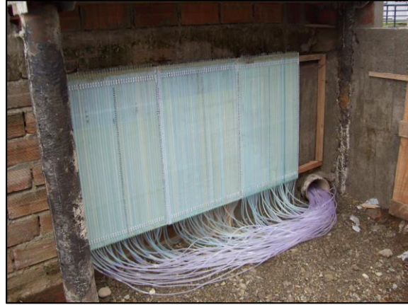
Figura 32. Tableros de medición Fuente: (INGETEC S.A, 2011)
