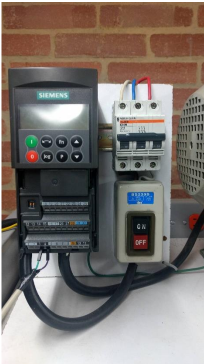
Ilustración 2. Variador con su Breaker e Interruptor
