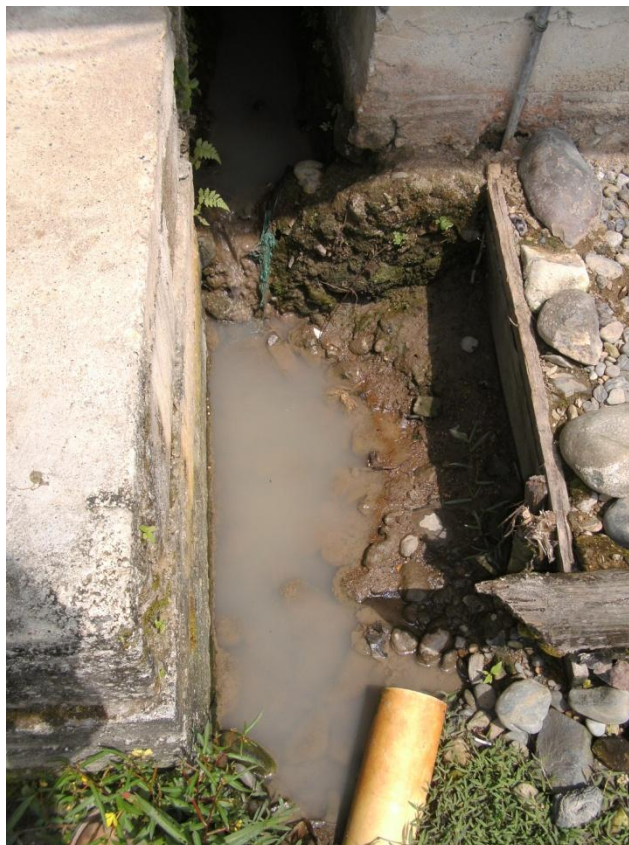
Foto 6: Vertimiento de aguas residuales entre dos viviendas. Municipio de Atrato.
