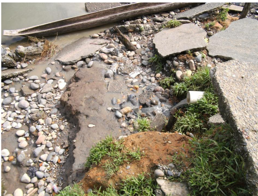
Foto 5: Vertimiento del alcantarillado en el río Andagueda. Antiguo lugar de PTAR. Municipio de Lloró
