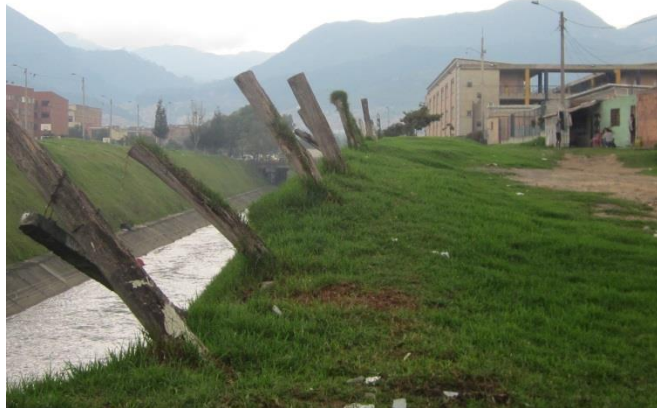
Fotografía No. 2. Carencia y deterioro espacio público Carrera 24 Tomada por el autor – Octubre 2014
