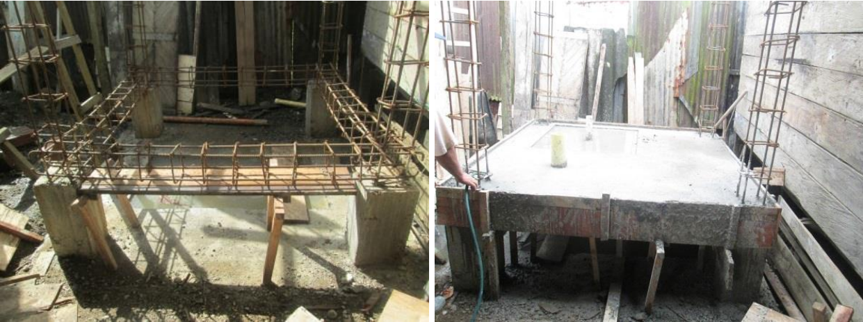
Figuras 6.2 y 6.3. Cimentación y construcción de unidad en estructura tipo palafito. Fuente: Minvivienda, 2016.
