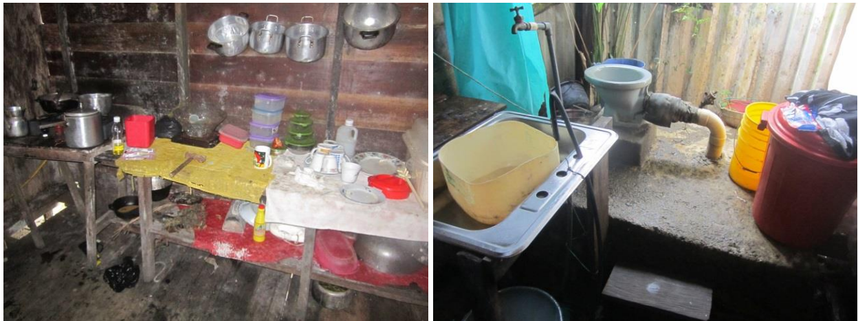
Figuras 3.1 y 3.2. Viviendas sin conexiones a los servicios de acueducto y alcantarillado y con necesidades de aparatos hidrosanitarios, Ciudad Mutis (Bahía Solano). Fuente: Minvivienda, 2016.
