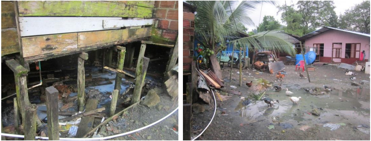
Figuras 2.1 y 2.2. Viviendas que no pueden ser intervenidas con el subsidio de conexiones intradomiciliarias al interior del Barrio Chocolatal. Fuente: Minvivienda, 2016.
