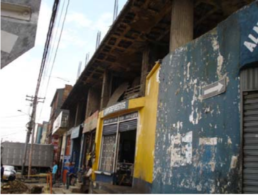
Imagen 1. Mal estado de las Construcciones
