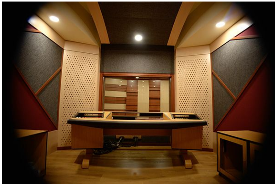
Ilustración 3. Control Room de Patio É Ropas. Fotografía por Aqstica
