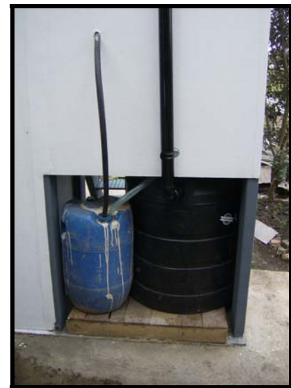
Tanque de orina y excretas con tubo de ventilación.
