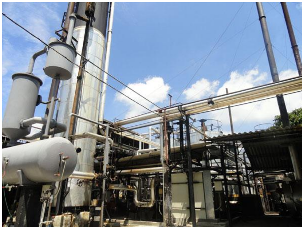
Fotografía 1. Torre de oxidación, planta MPI Barrancabermeja
